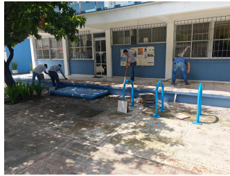
Levantamiento de piso en andador de dirección.
