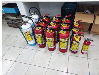
Extintores entregados a la unidad académica.
